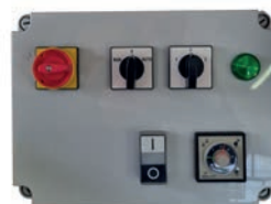
7042 - Impianto con radiocomando
